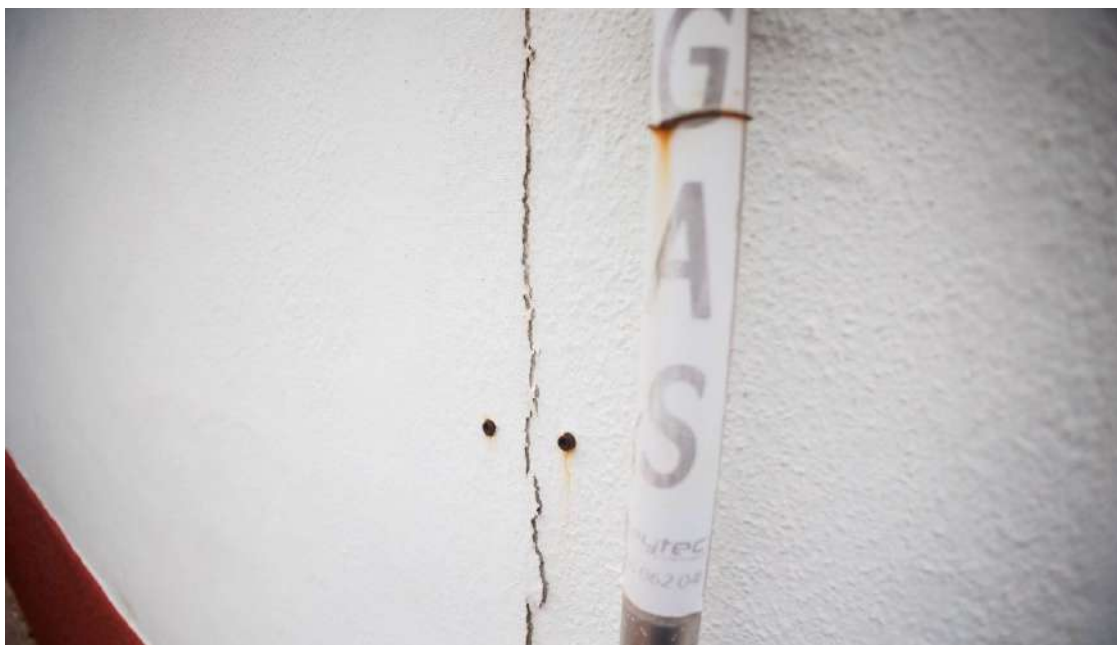
Grietas en uno de los edificios. MANU GARCÍA
